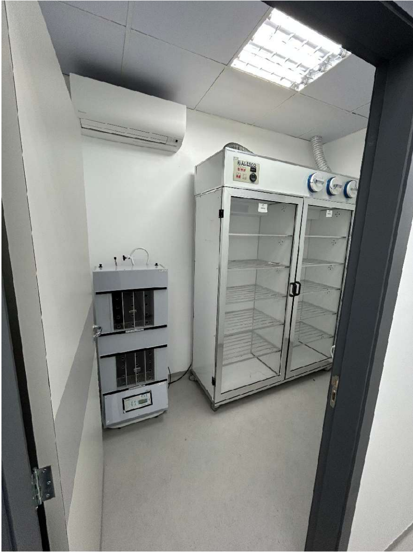
Sala de quarentena 2
